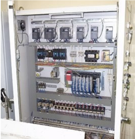
輸送容器搬送装置制御盤
