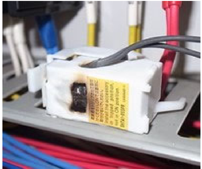
焼損した電圧引き外し装置
